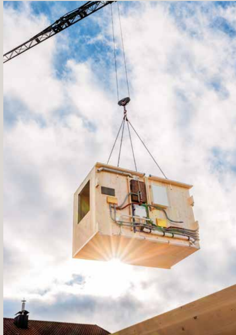
Die Modulbäder werden vorgefertigt angeliefert, per Kran präzise eingehoben, fachgerecht montiert sowie angeschlossen.
